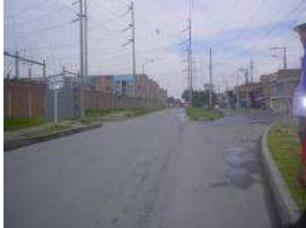
Apozamientos – Falta demarcación
