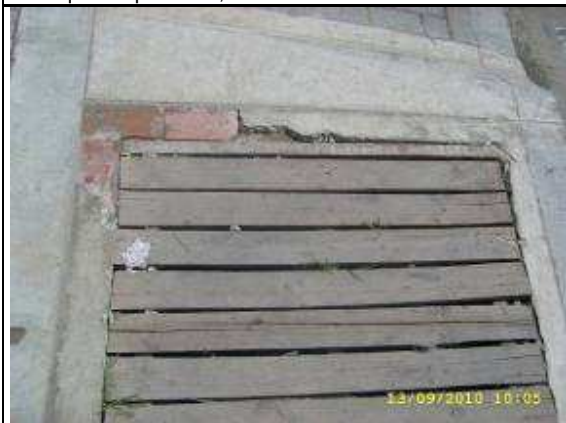
Alcorque desportillado, calles 108 a 109 costado occidental.
