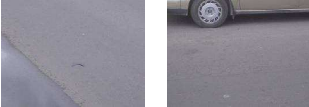
Núcleo sin sellar – A lo largo del tramo presenta fisuras Terminada en el 2009
