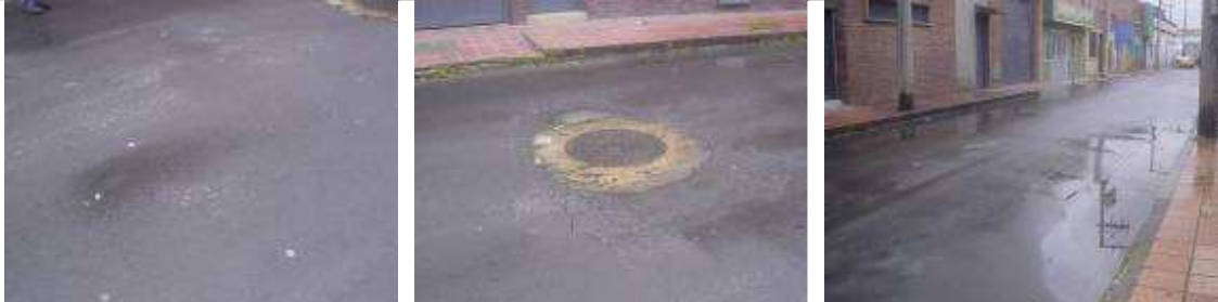
Fisuras y apozamiento Terminada en el 2009
