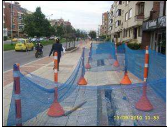
Sectores con obras inconclusas, calle 107 a 109 costado oriental.
