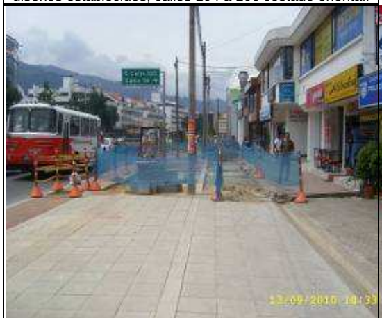
Incumplimiento del POT por no realizar la subterranización de las redes, posiblemente estaos andenes serán intervenidos por las empresas de servicios públicos, calles 116 a 118 costado occidental.
