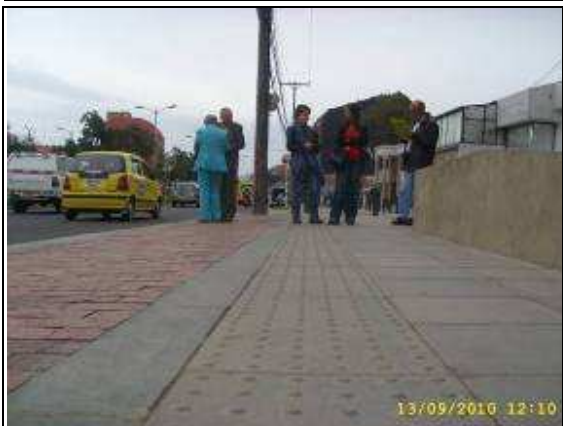
Loseta táctil alerta mal instaladas en andenes, calles 104 a 106 costado oriental.
