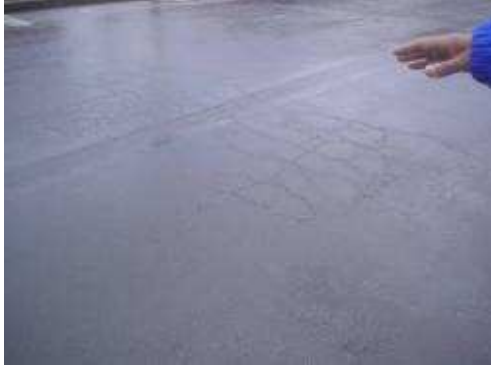
Piel de cocodrilo en calzada sur Frente a placa 19-06
