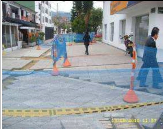
Sectores con obras inconclusas, calle 108 costado oriental.
