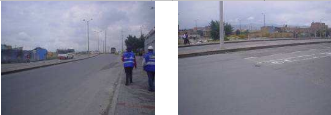
Sin demarcar – Hueco en la calzada norte sur Terminada en el 2009
