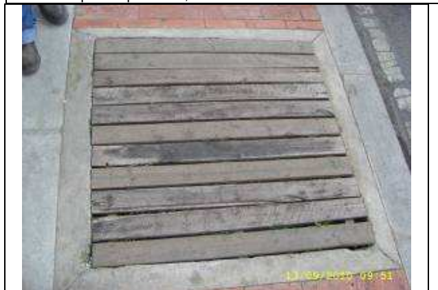
Alcorque desportillado, calles 106 a 109 costado occidental.
