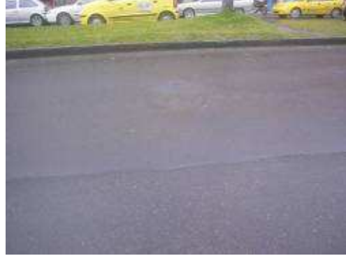
Hundimiento en calzada norte Frente a placa 19D-68
