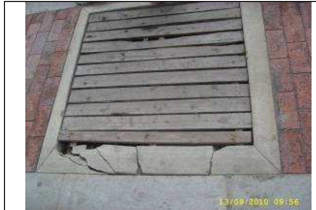
Alcorque desportillado, calles 106 a 109 costado occidental.
