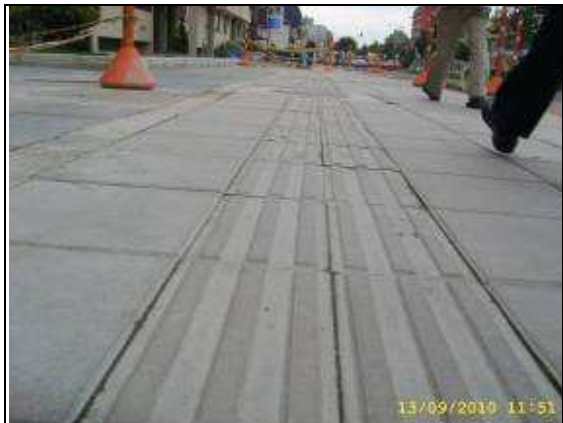
Losetas táctil guía que no corresponden a las especificaciones técnicas, calles 109 a 112 costado oriental.
