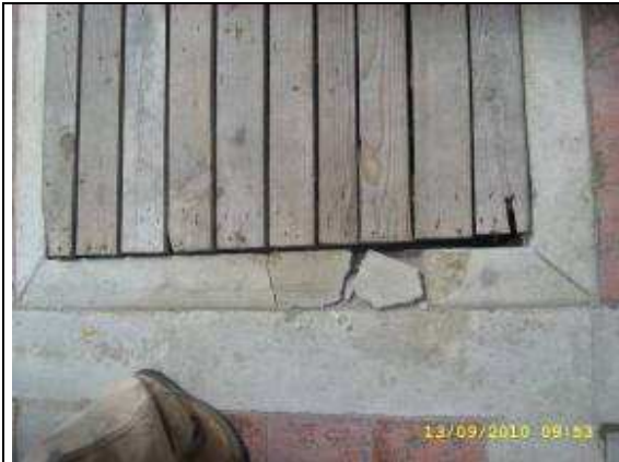
Alcorque desportillado, calles 106 a 109 costado occidental.
