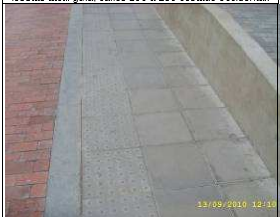
Loseta táctil alerta instaladas que no corresponden a los diseños establecidos, calles 104 a 106 costado oriental.
