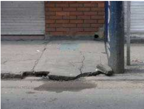
Andén roto frente a la vivienda con placa 37-63
