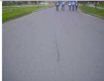
Reparación fisura pavimento nuevo Falta demarcación
